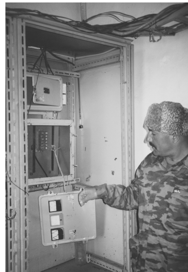
写真4 ロシア軍に破壊された設備を説明するタジク兵
